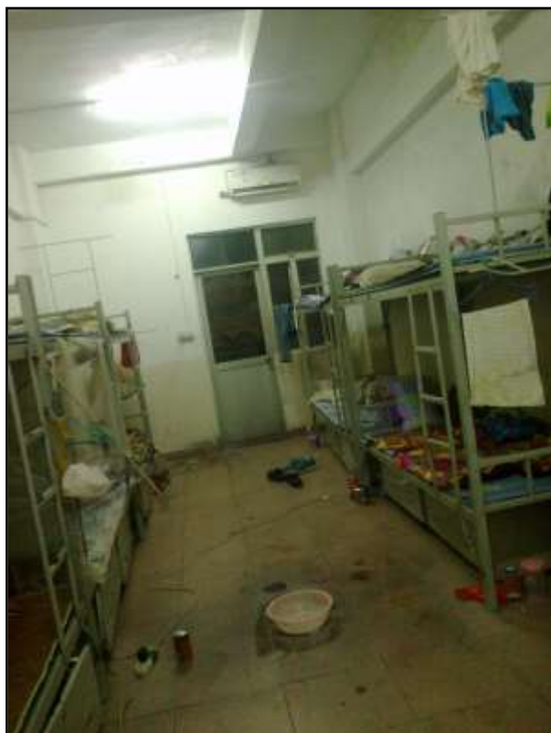
宿舍房顶漏水，工人用盆接水
